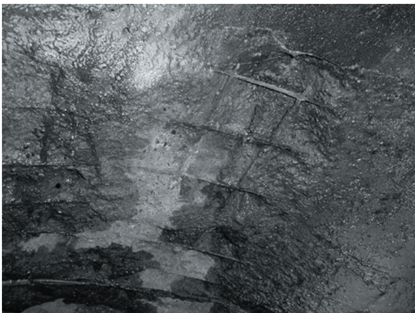
FOTOGRAFÍA 3. Área de armaduras expuestas que fue cubierta con hormigón. 2005.
