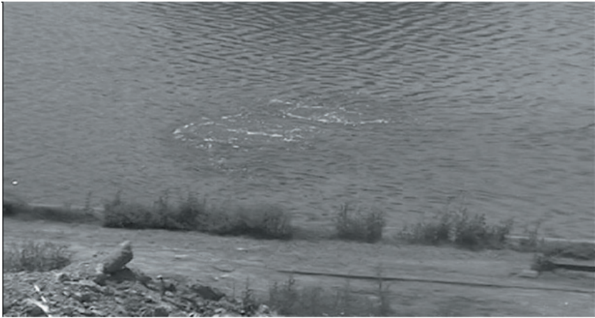
FOTOGRAFÍA 1. Burbujeo de aire en la superficie líquida del canal sobre el primer tramo del sifón, antes de la intervención de 2005.
