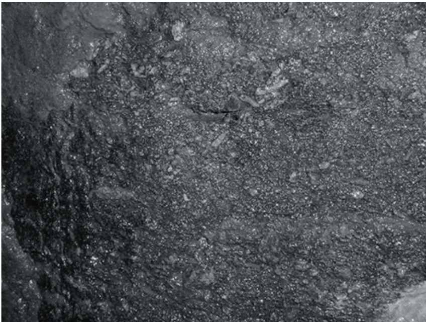
FOTOGRAFÍA 2. Vista de una superficie sana. 2005.
